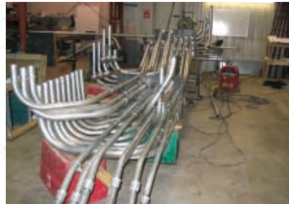
Prefab Conduit Rack
